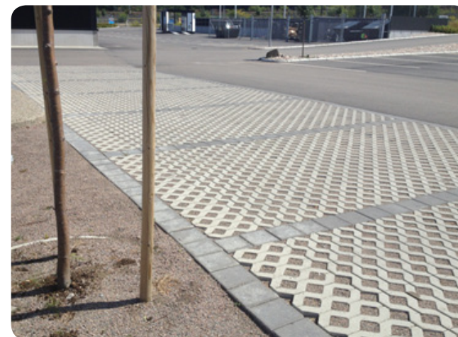
Bild 4. Exempel på lokalt omhändertagande av dagvatten med genomsläpplig beläggning på parkeringsplats.
