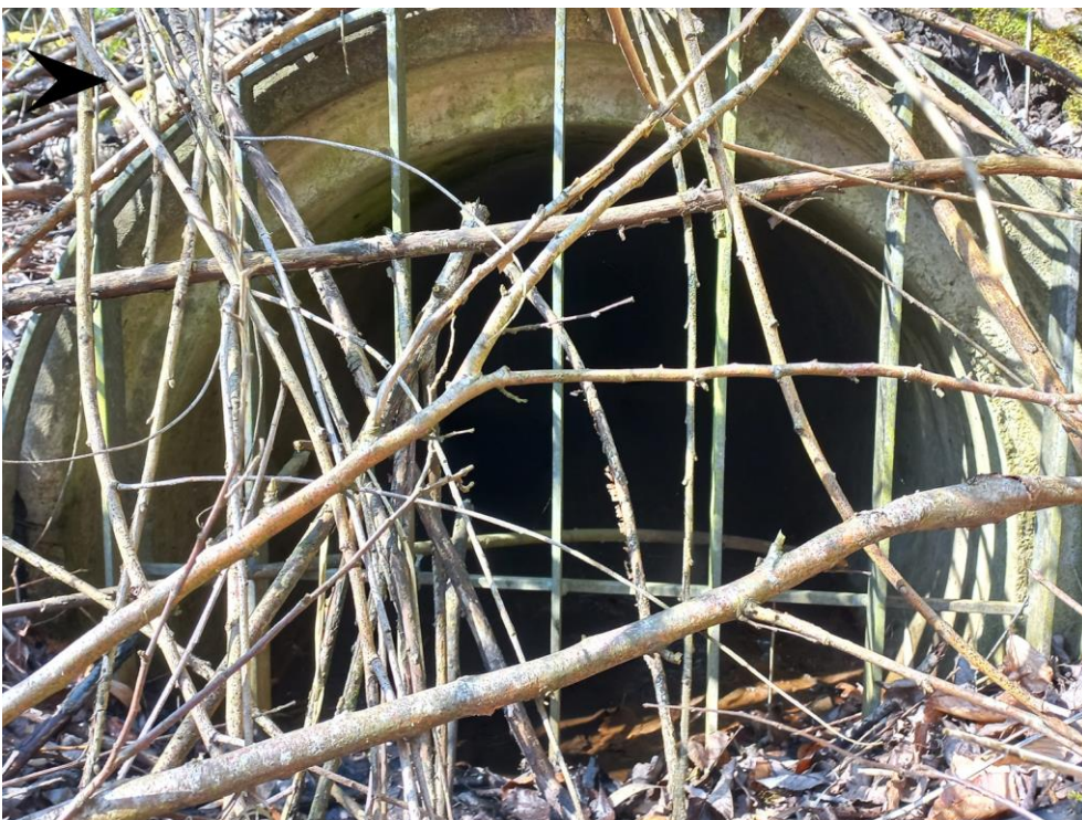
Figur 4-3. Inlopp till dagvattenledning i diket norr om Kungsgårdsleden. Norr är höger i bilden.
