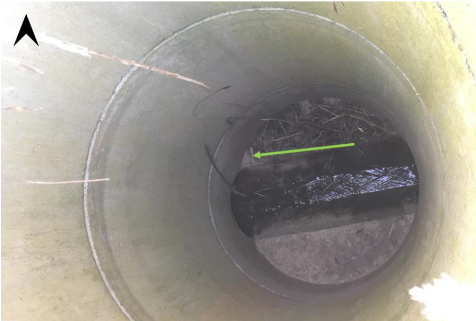
Figur 4-2. Nedstigningsbrunn norr om Kungsgårdsleden. Grön pil indikerar flödesriktning. Norr är uppåt i bild. Bild: Sweco.
